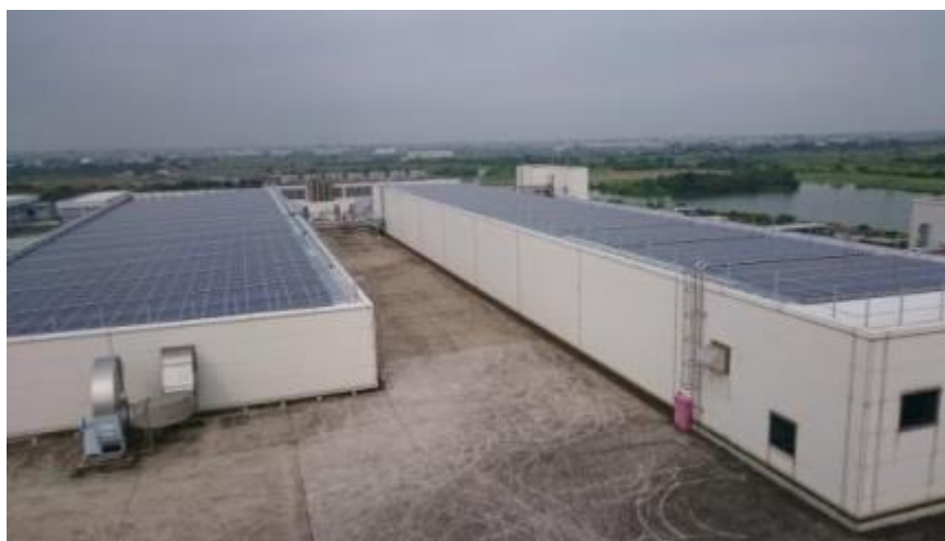
太陽能發電系統設置現況
